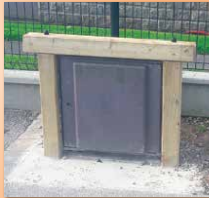
Sécurisation des coffrets électriques aux abords des écoles
